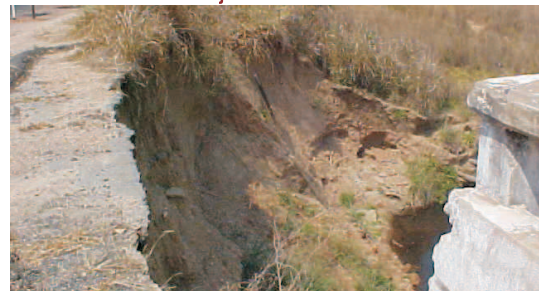
GO-210 (trecho Água Limpa – Marzagão) Verifica-se aumento considerável da erosão no encabeçamento da ponte (16/09/08).
