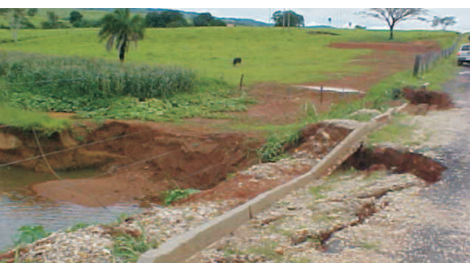
GO-210 (trecho Água Limpa – Buriti Alegre) Erosão já atinge o pavimento da rodovia (27/01/09).
