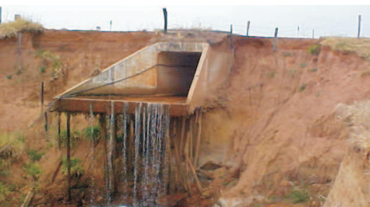
GO-210 (trecho Água Limpa – Buriti Alegre) Estacas de madeira sustentam o bueiro (16/09/08).
